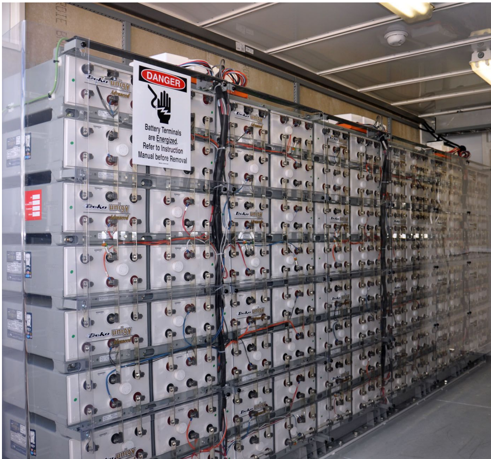
Figura 1-7: Sistema de armazenamento direto de energia elétrica em baterias (PNM Prosperity Energy Storage Project).
